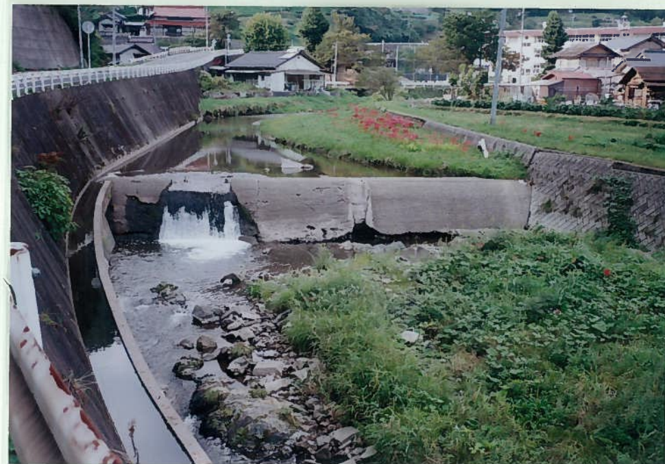
86)月田川 3. 頭首工 h=2m 基礎の洗掘を受けて いる。
