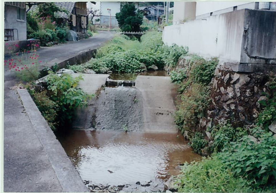
85)岩井谷川 22. 頭首工 h=1.5m
