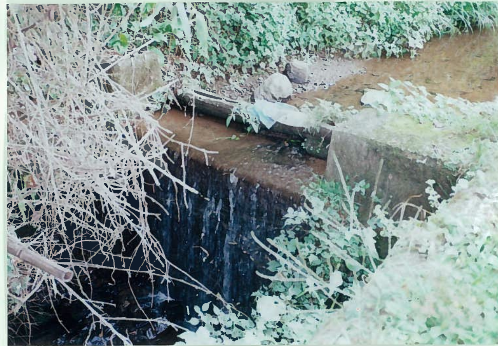
85)岩井谷川 28. 頭首工 h=1.5m
