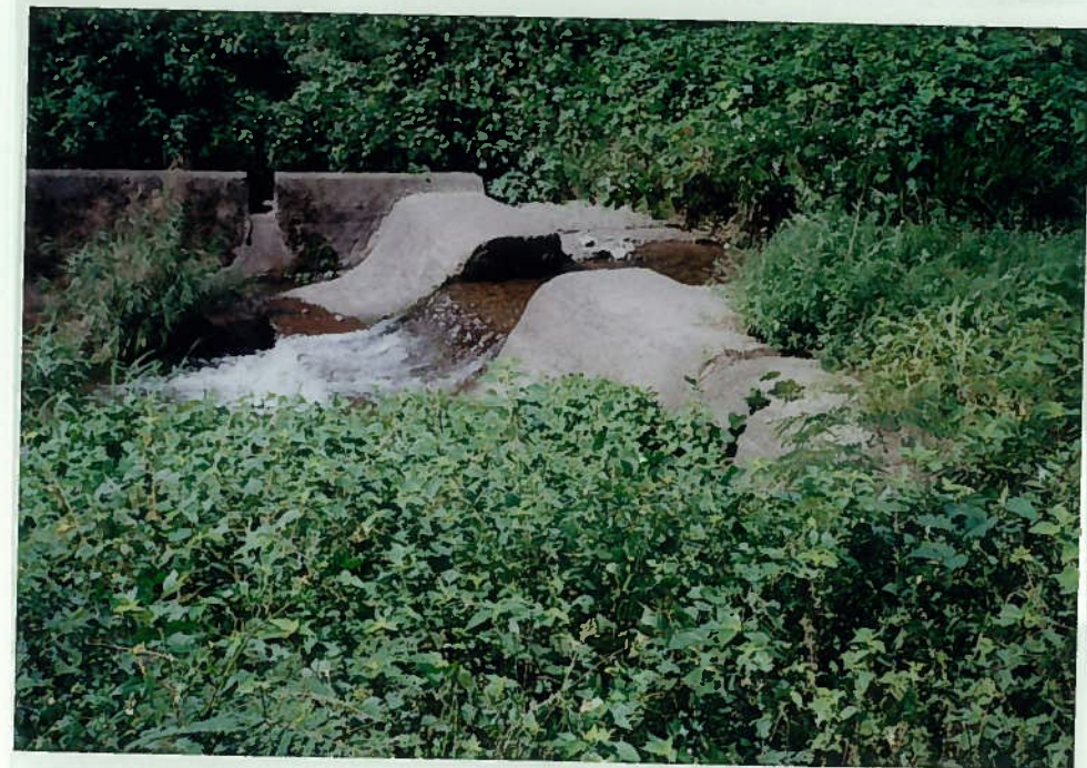
84)後谷川 3. 頭首工 h=1m
