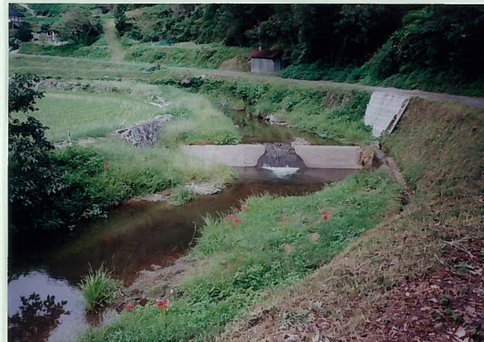
84)後谷川 14. 頭首工 h=1m
