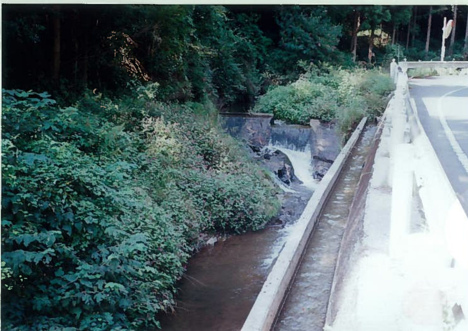
84)後谷川 21. 頭首工 h=2m
