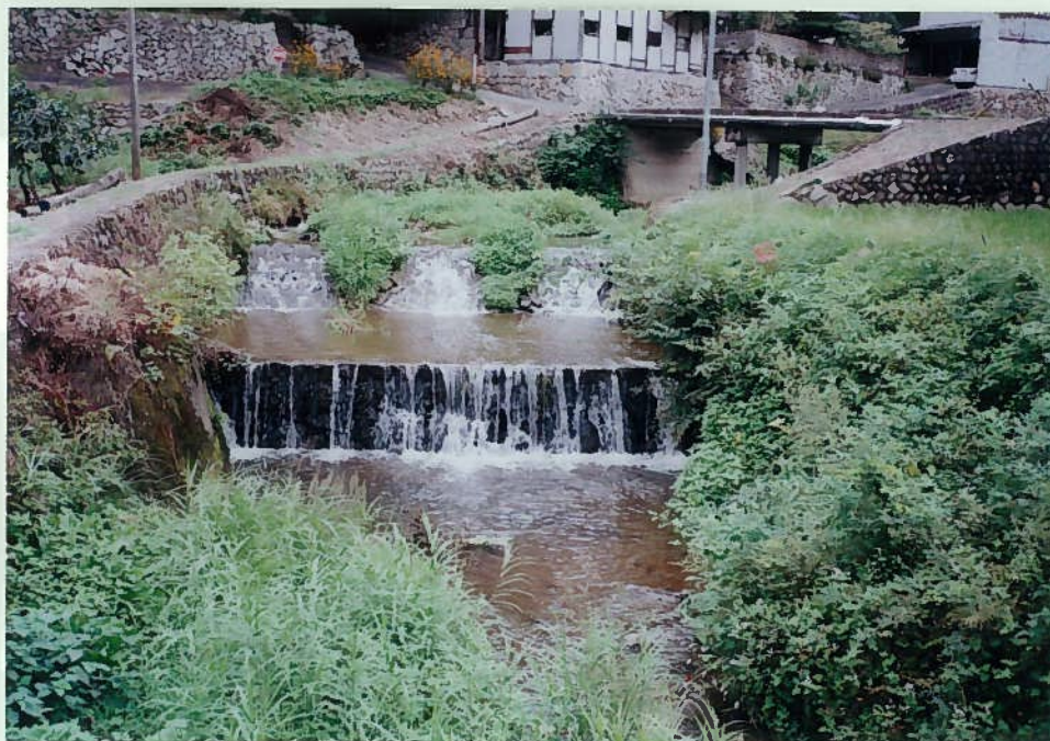
84)後谷川 18. 床留工 h=1m×2段 魚の遡上はやや困難 である。
