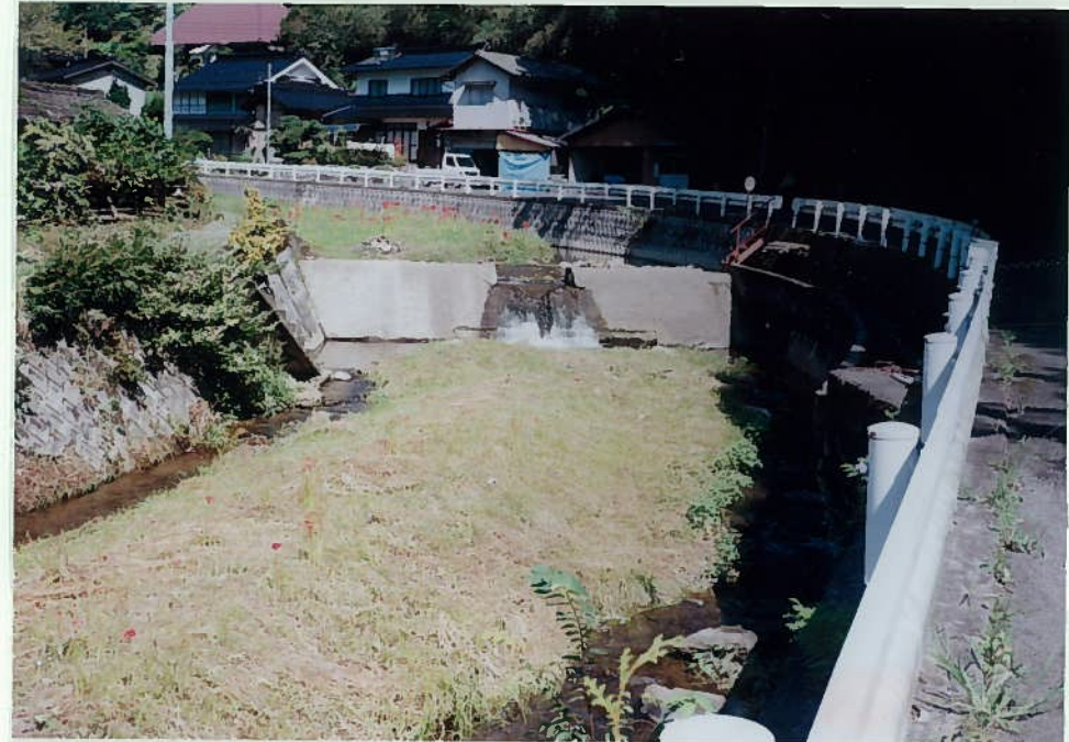
84)後谷川 2. 頭首工 h=1.5m
