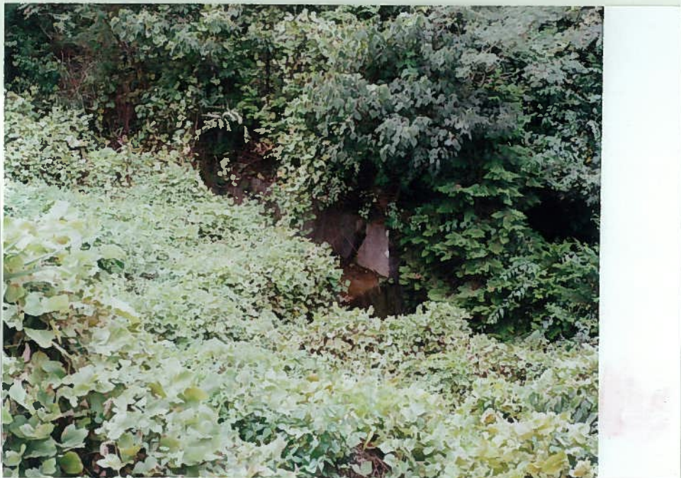
83)和田川 29. 床留工 h=3m 魚の遡上は困難である。
