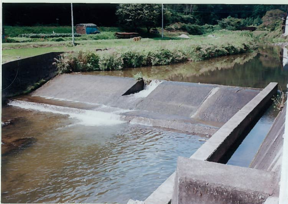
82)月田川 12. 頭首工 h=2m 緩勾配で魚にやさしい構造である。
