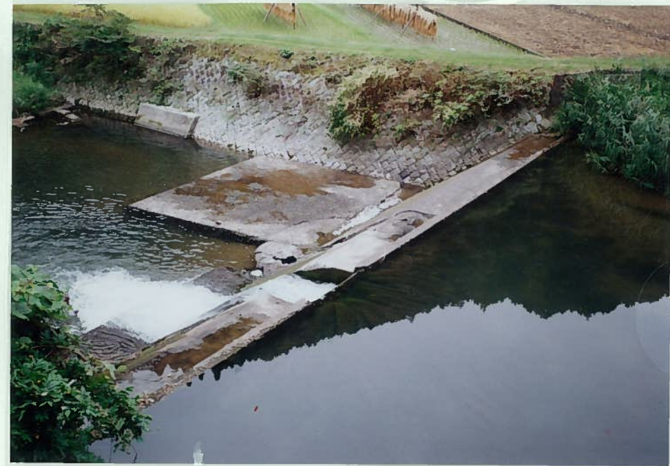
82)月田川 1. 頭首工 h=3m 魚の遡上は困難
