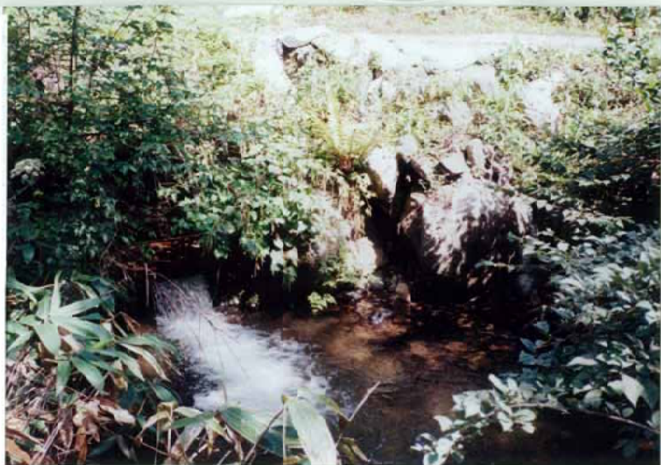
80)金ケ谷 37. 道路横断パイプ 魚は遡上し難い。
