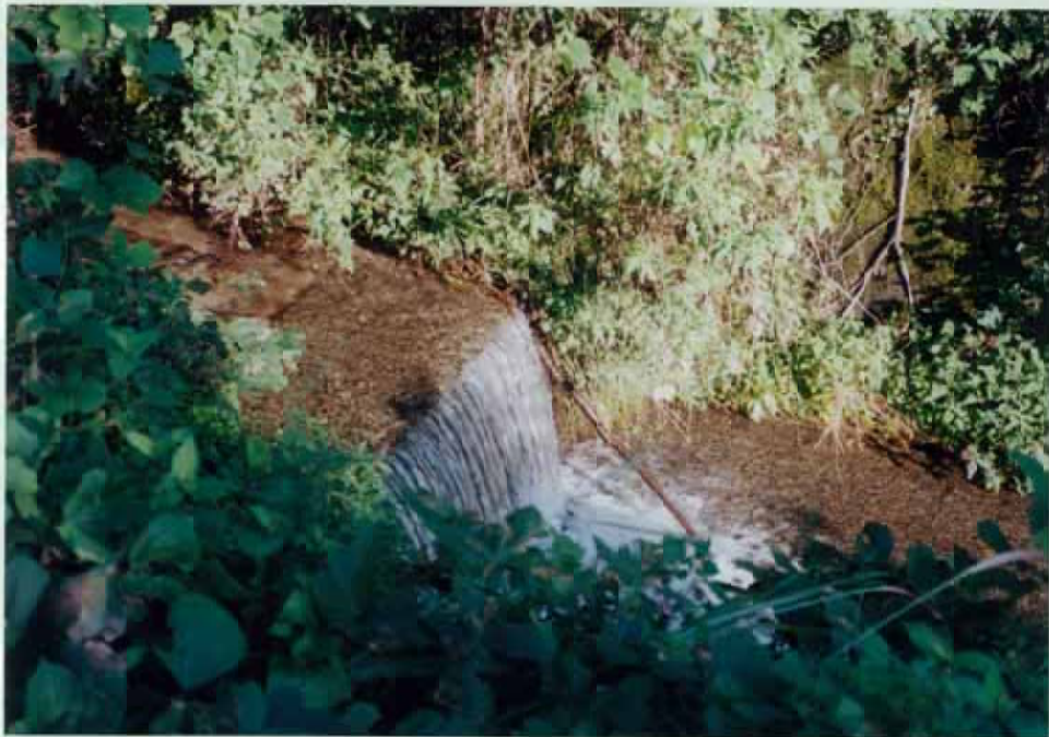
79)浦手川 8. 床留工 h=1m これより下流は護岸工、上流は自然川である。
