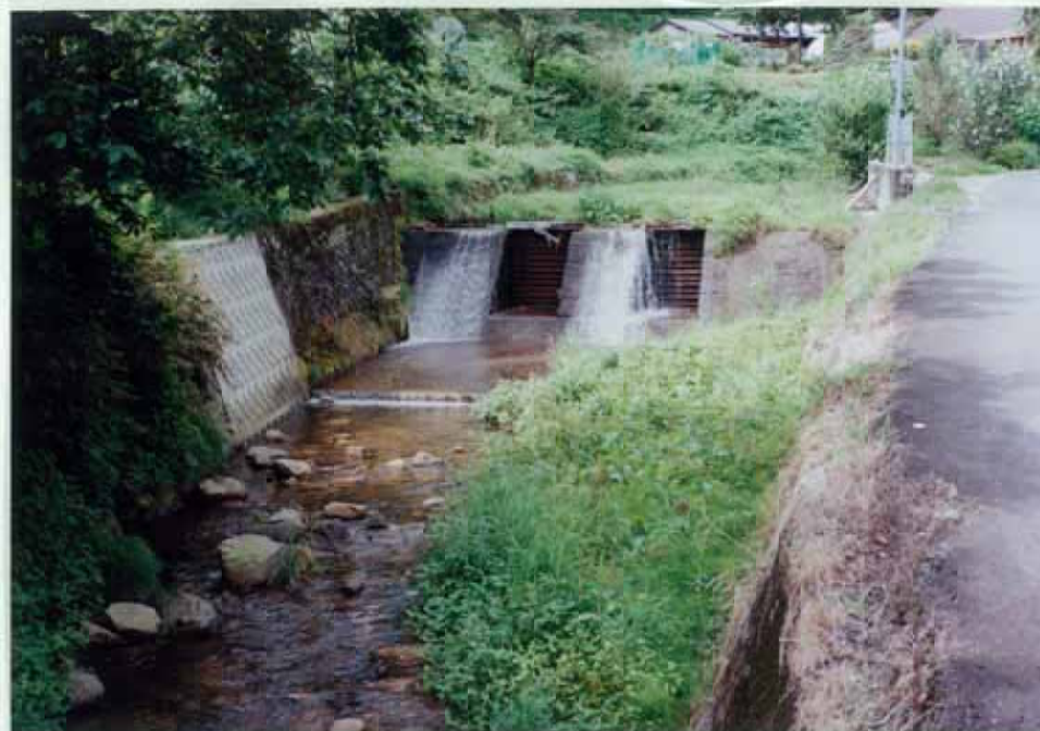
81)高下川 16. 頭首工 h=2m 波板を外せば魚の遡 上は可能であるが堆 砂している。
