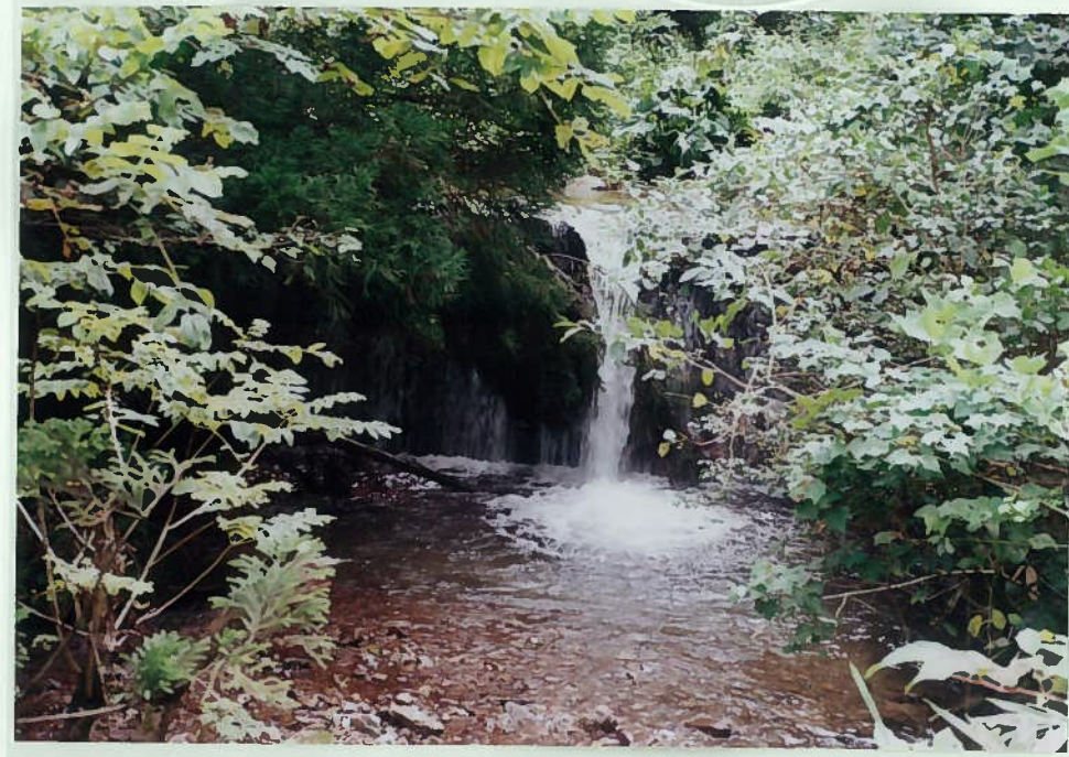
78)戸島川 16. 床留工 h=3m 魚の遡上は困難であ る。
