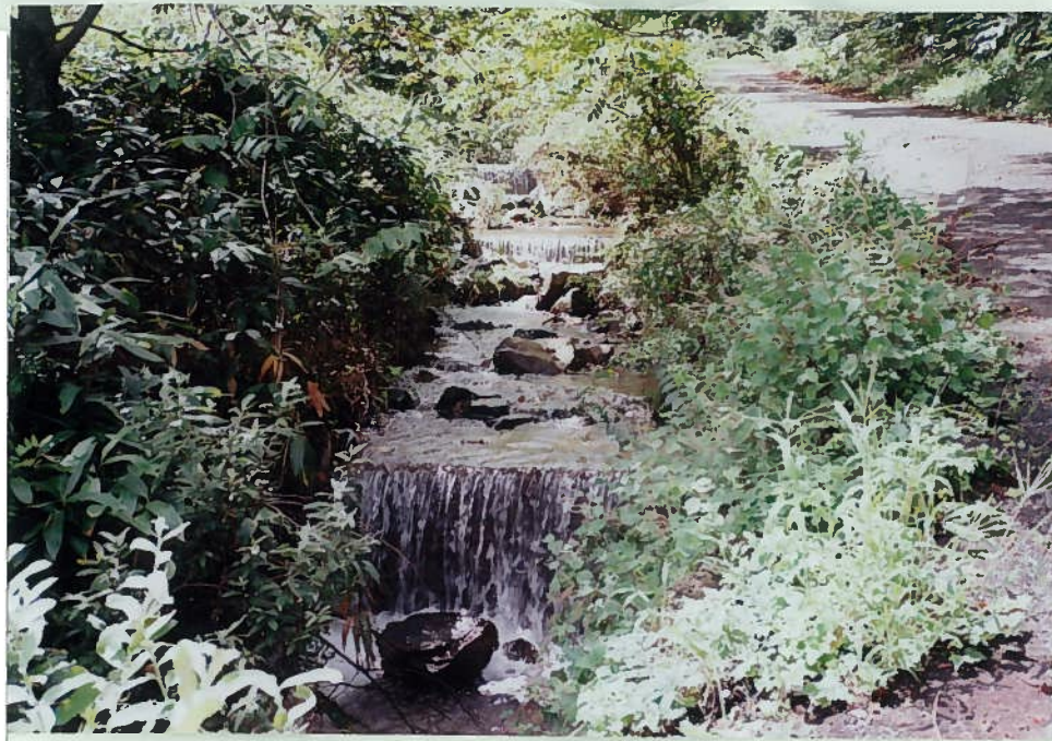
78)戸島川 19. 床留工 h=1m×3段 魚に配慮した川である。
