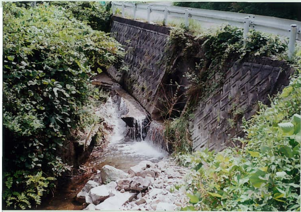
76)山路川 7. 床固工と道路横断 BOX(φ1m) 魚は遡上し難い。
