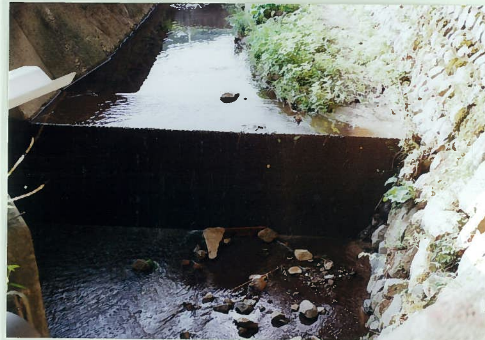
75)森谷川 2. 三面張段差工 魚はいない。
