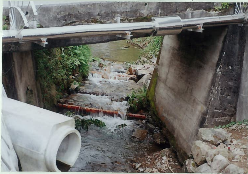
75)河田川 16. 床留工 丸太と自然石を積んで侵食防止工としている。
