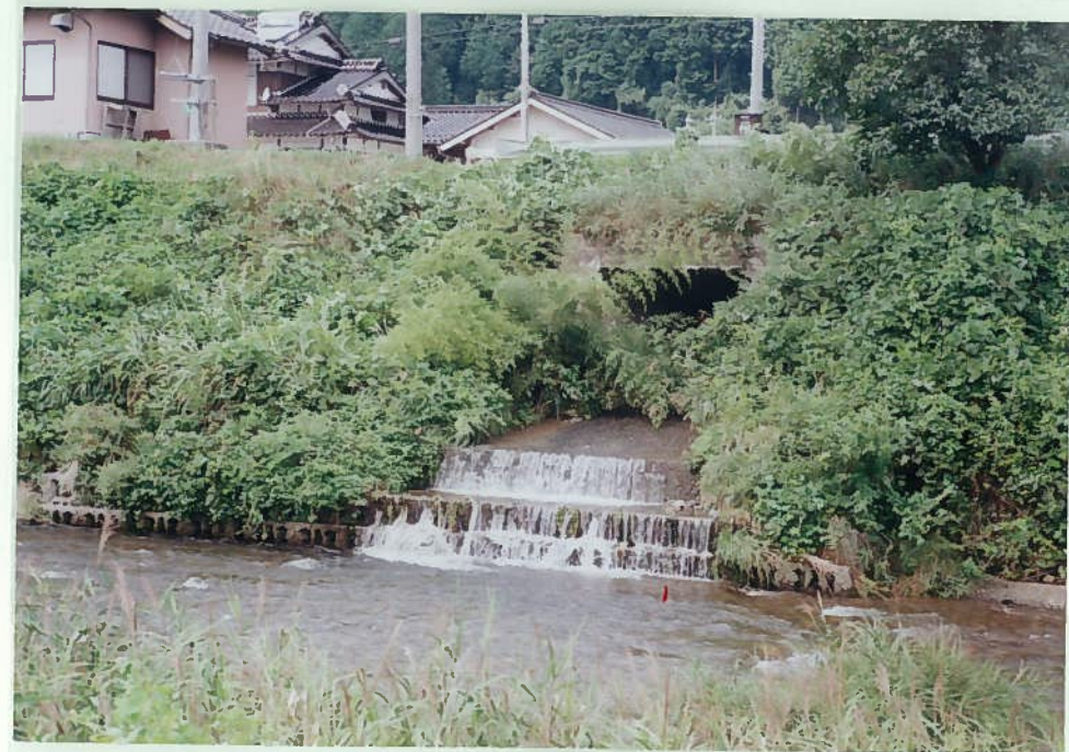
72)平島川合流点 20. h=1.5m 魚の遡上は困難である。
