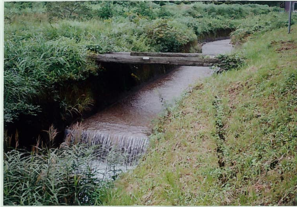
75)平島川 24. 三面張+段差工 h=1m
