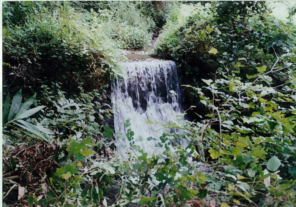
71)打火谷川 23. 床留工 h=3m 魚の遡上は困難であ る。
