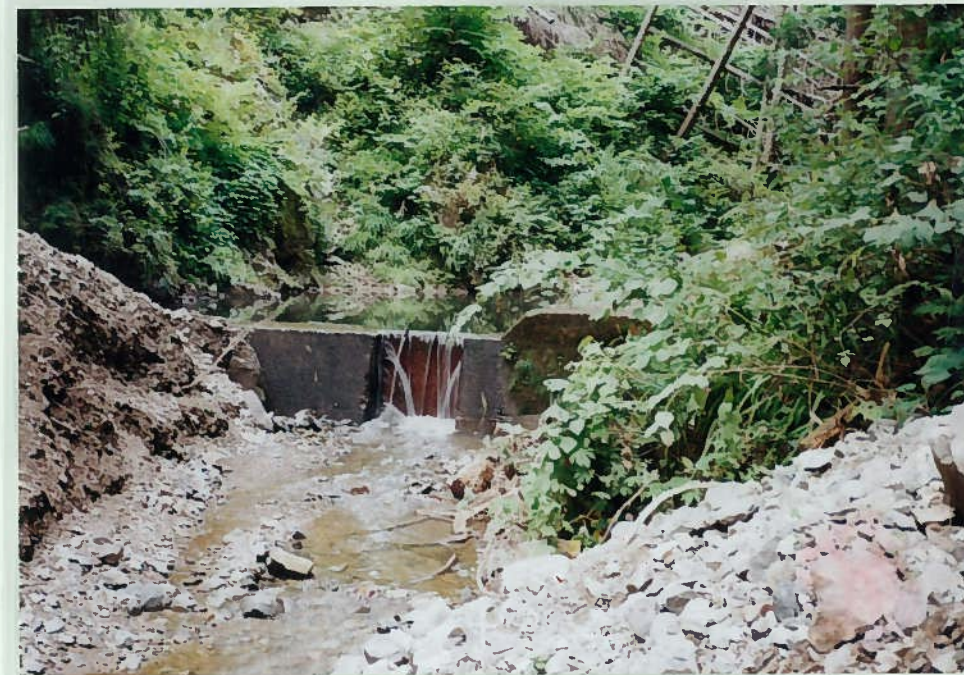
70)高山川 14. 床留工 h=1m 崩壊土砂で埋まった が、土砂を除去して いる。
