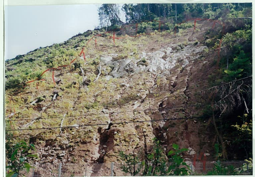
70)高山川 7. 植林の崩壊跡 表土が全て滑落している。
