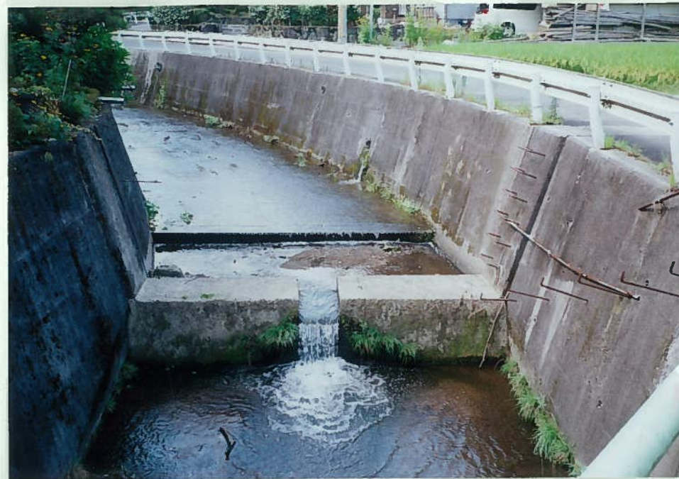
67)谷山川 1. 三面張河川で段差工 0,5mがある。
