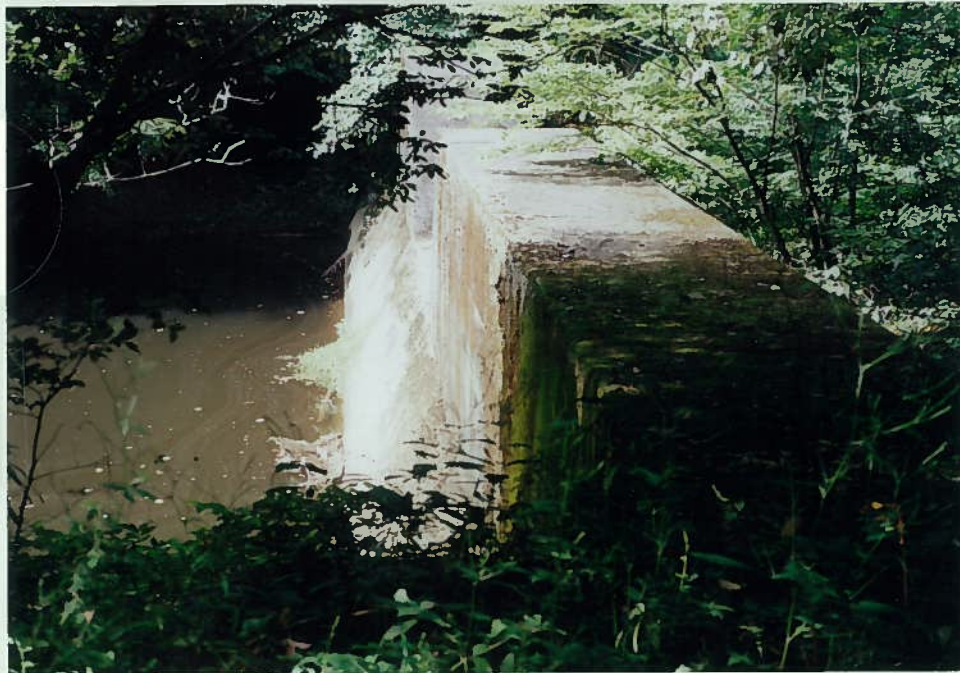
67)谷山川 5. 砂防ダム H=10m 上流は泥水がたまり、 下流側は三面張工と なっている。
