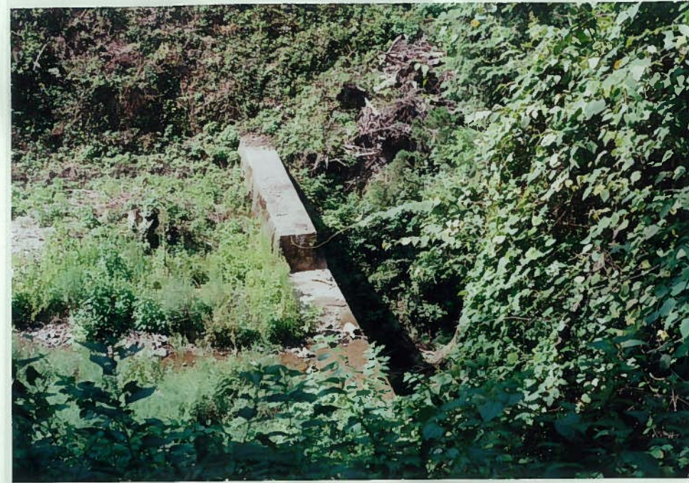
67)谷山川 7. 砂防ダム H=5m 流木と土砂で溝砂と なっている。
