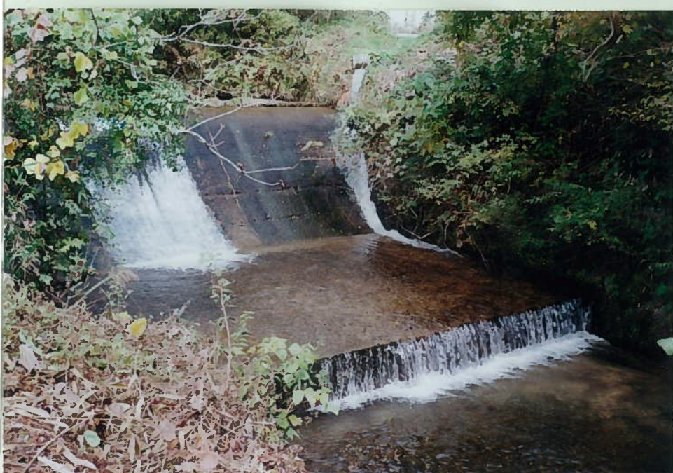
60)苗代川 3. 床止工 h = 3 m 魚の遡上は困難であ る。
