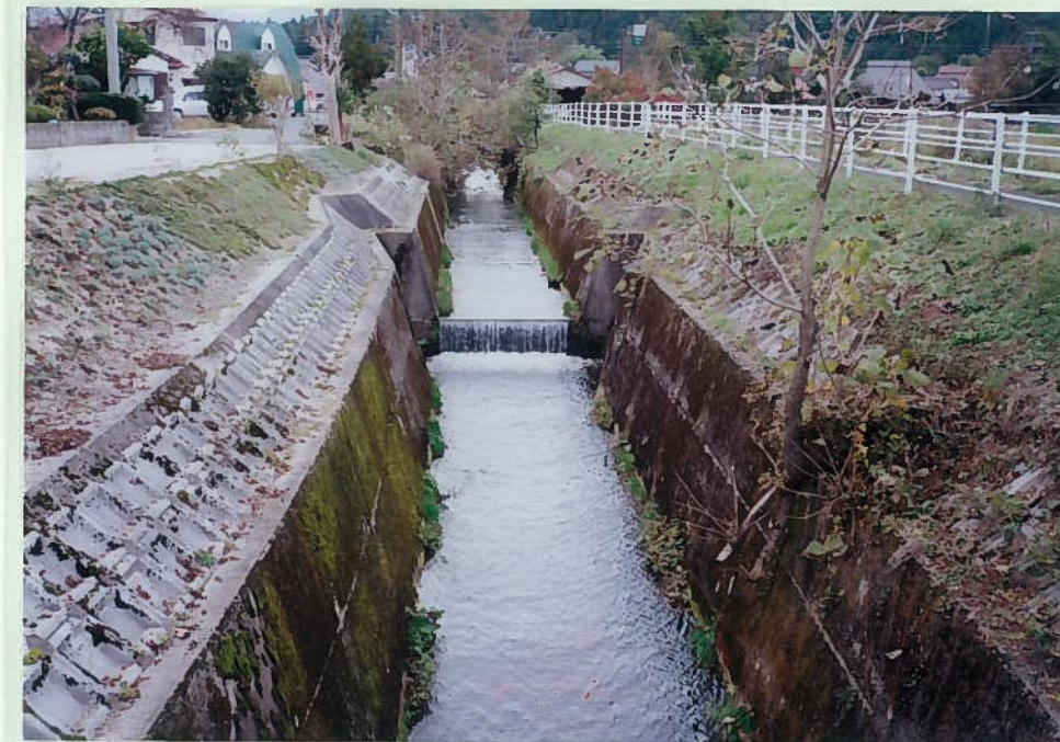
59)明連川 16. 支川 三面張となり魚はす めない。
