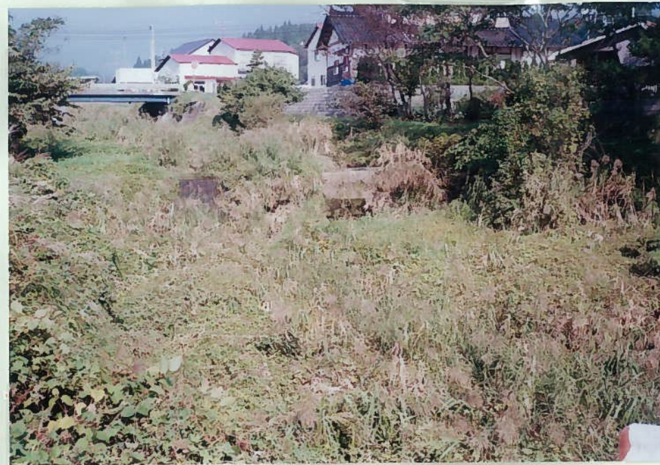
54)三谷川 1. 床止工 h = 2 m 魚の遡上は不可能に ちかい。
