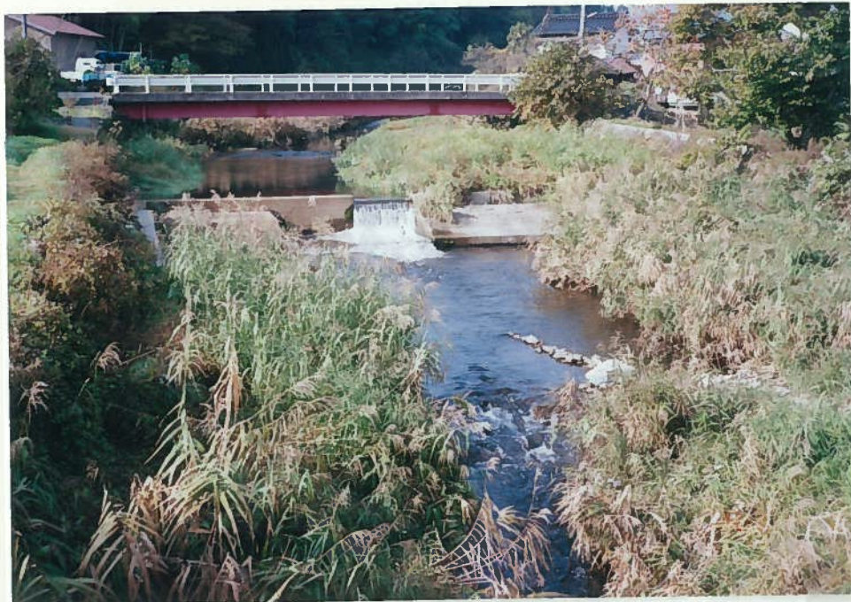
50)旭川源流 18. 頭首工 h = 1.5 m 魚道はないが魚の遡 上は可能である。
