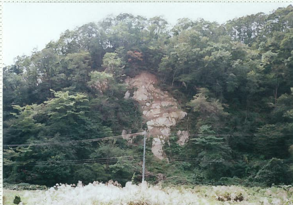
47)藤森川 22. 自然林の崩壊。 表土は0.5m以下で岩 盤が浅い。
