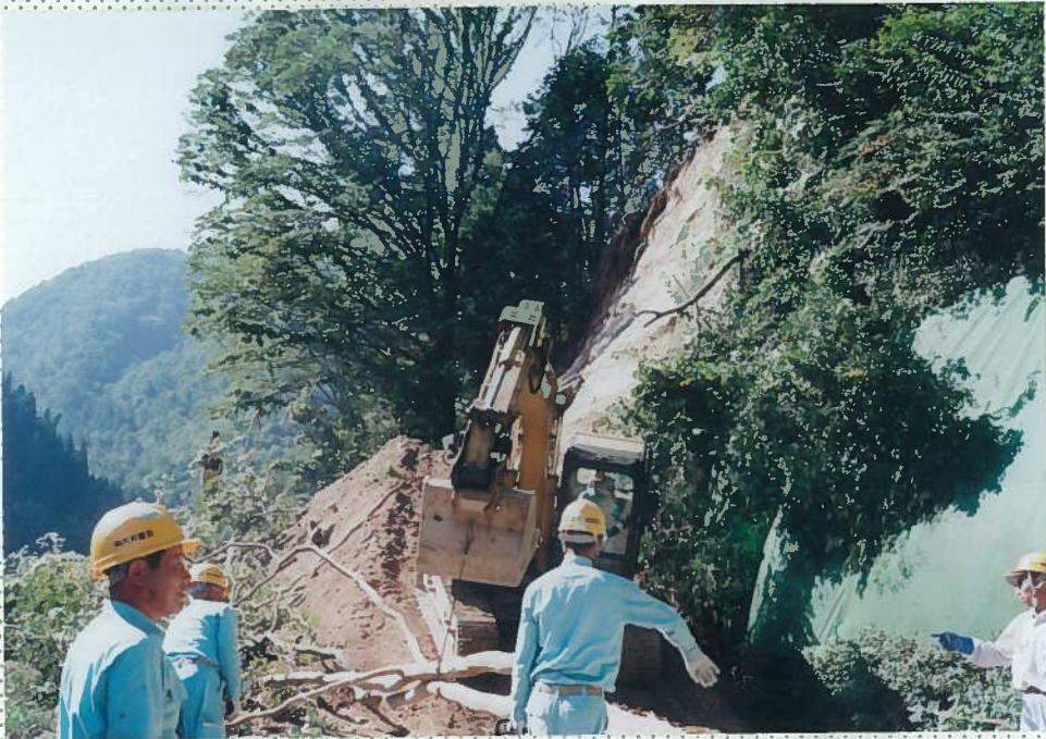
湯原町仲間 台風13号(9月17日) による片岩の岩盤崩壊により、R313号は 通行止めとなる。
