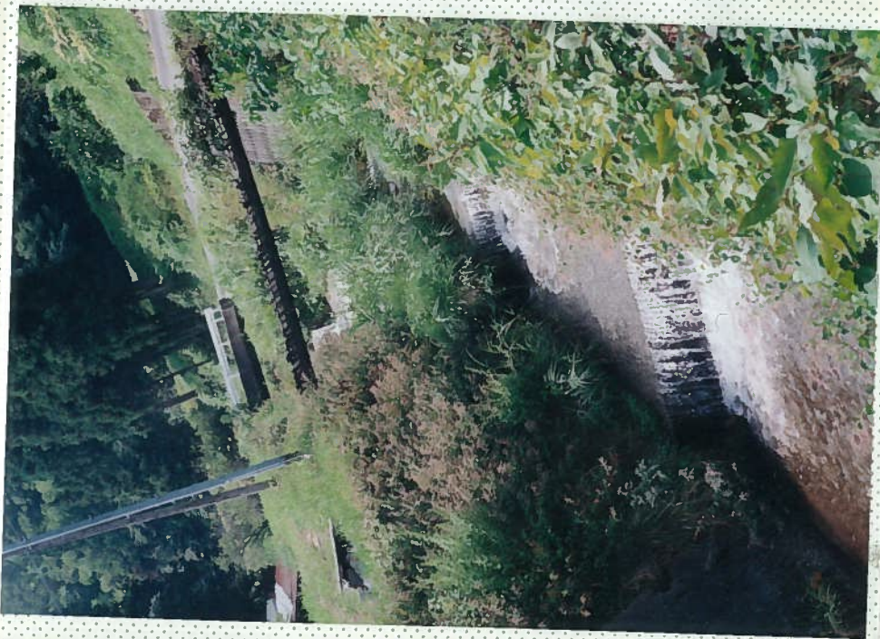
37)福井川 25. h = 1.0 \sim 1.5\text{m} の段 差工が連続しており、 魚の生息・遡上は困 難である。
