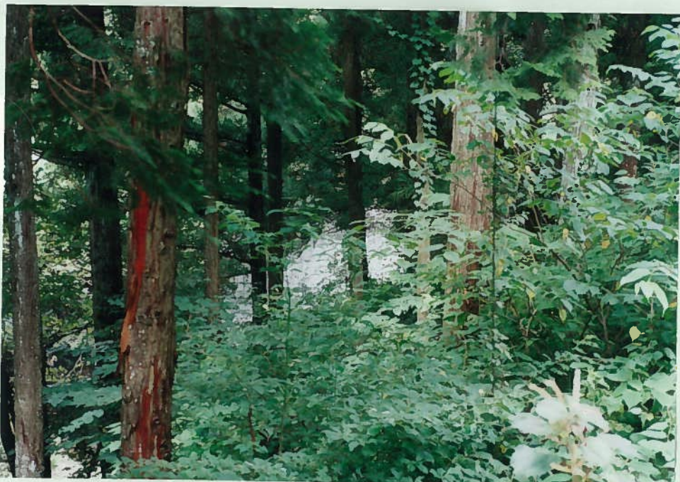
35)鉄山川 11. 砂防ダム。h = 3 m 林の下に砂防ダムが ある。
