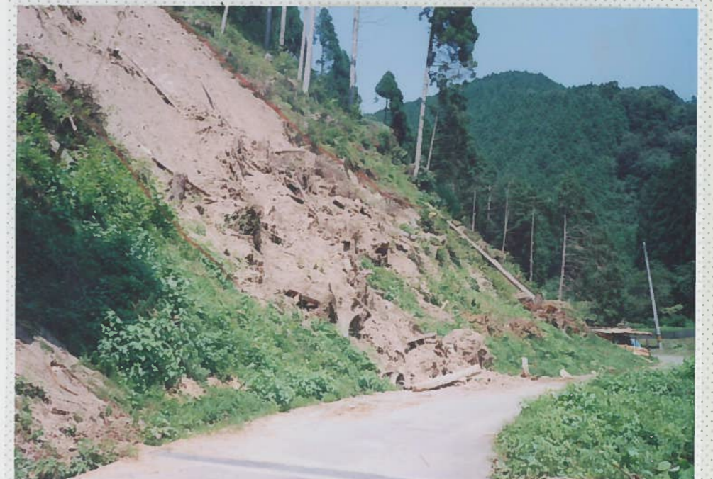
27)三坂川(久世) 15. 同上。 土砂流出の基となっ ている。
