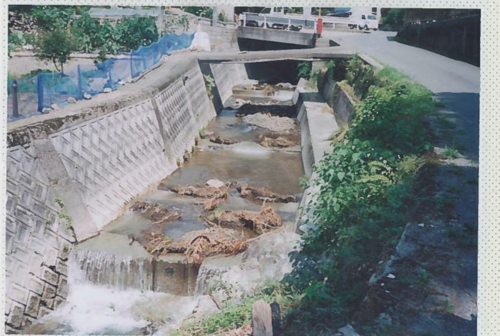
25)山生川 12. h = 1.5 m。 土砂・ゴミ・木材が流出し、川の生息環境を悪化している。
