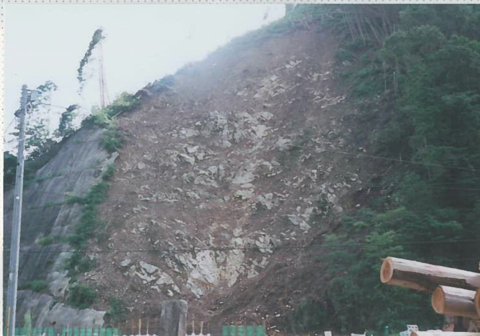
22)余川 20 崩壊地。 土砂はほとんど崩れ 落ちている。
