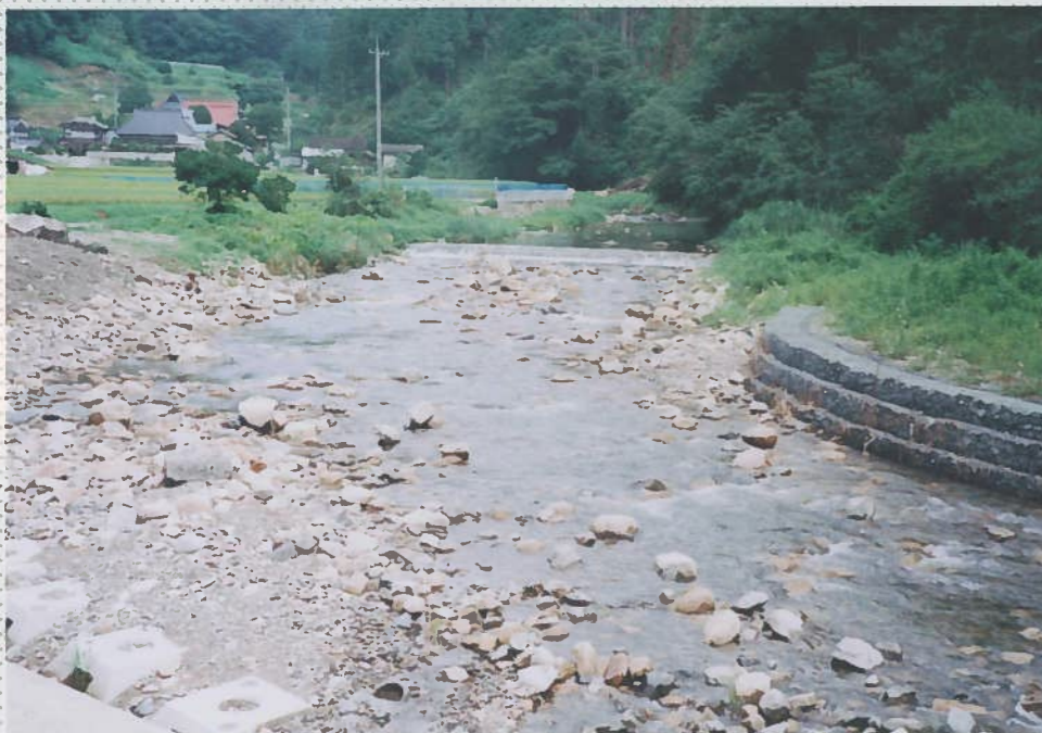
22)余川 14 h = 1 m。 礫・土砂の流出が多 い。
