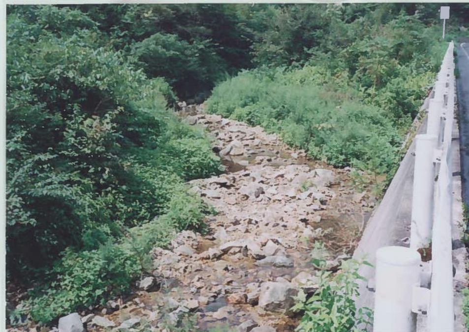
23) 余川 39 川床状況。 砂礫の流出が多い。
