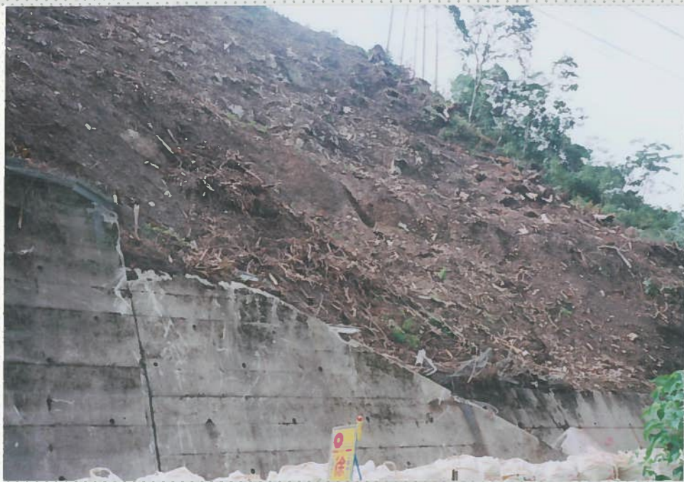
22)余川 19 大規模崩壊地。 多量の倒木と土砂が 流出している。
