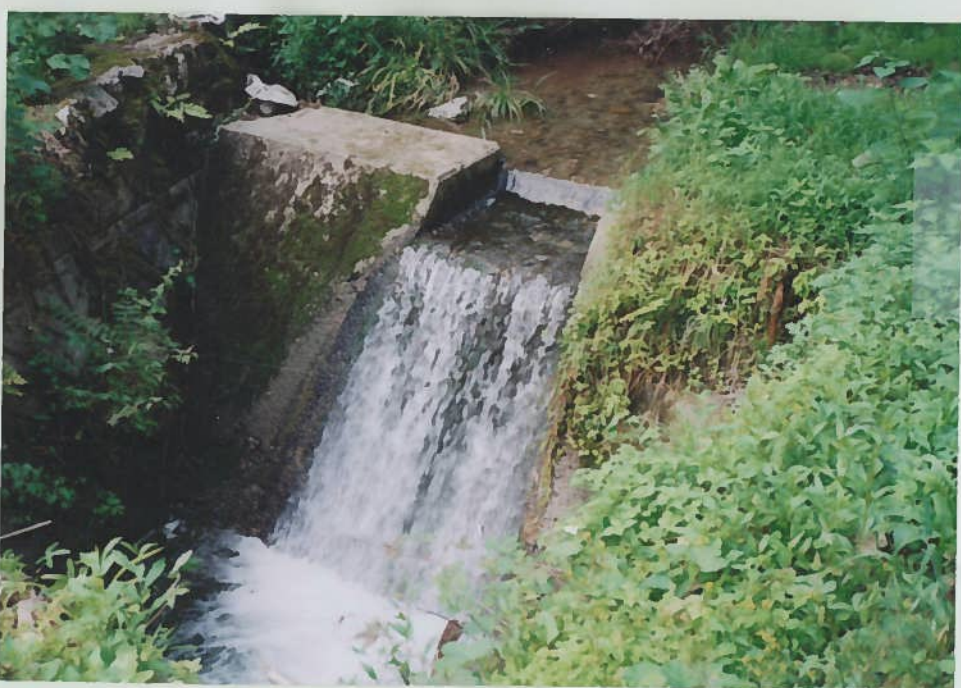
17)河内川(西谷川) 42. h = 3 m。 魚の遡上も困難であ ろう。
