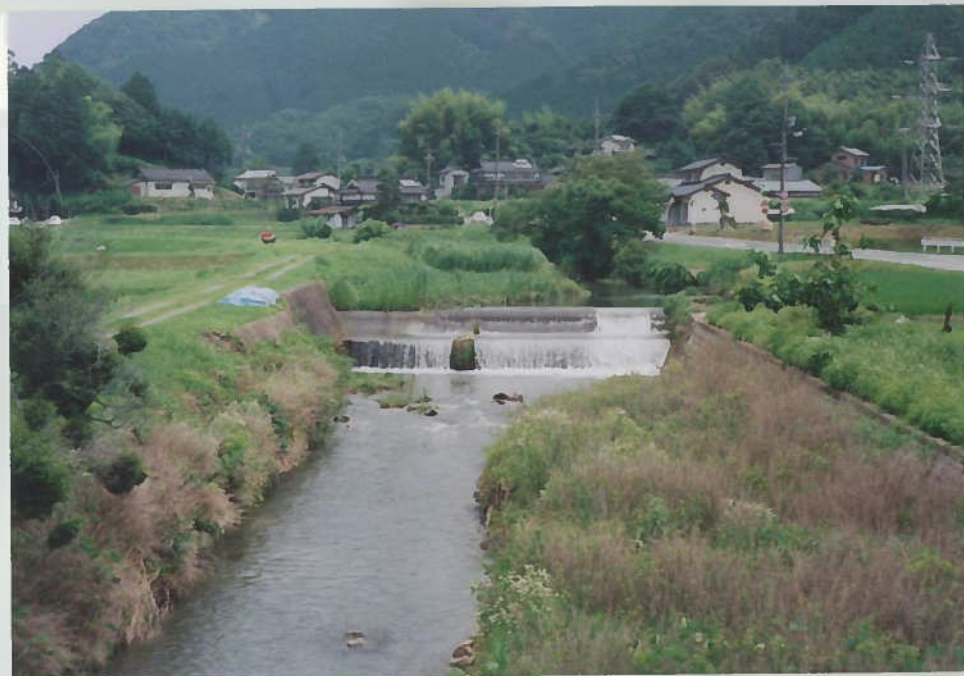
17)河内川 14. h = 3m。 泥岩が分布し、河床は侵食され易い。
