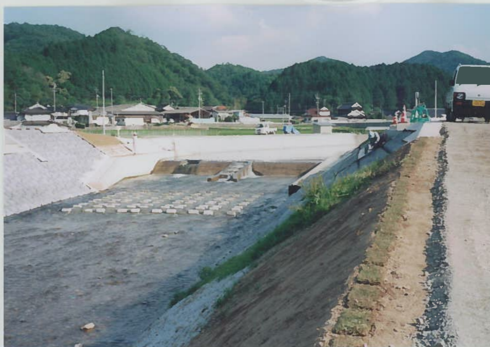
15)中津井川 12 護岸工事中 頭首工に階段工がある が床固めをしており魚 の住処の少ない川であ る。
