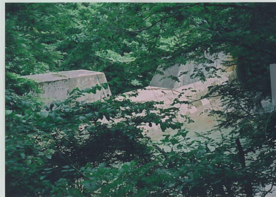
13)興法地川 19 h=10m 砂防ダム 泥が堆積している。
