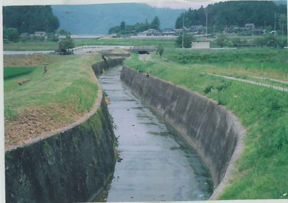
13)興法地川 12 三面張工で水は無く 魚もいない。
