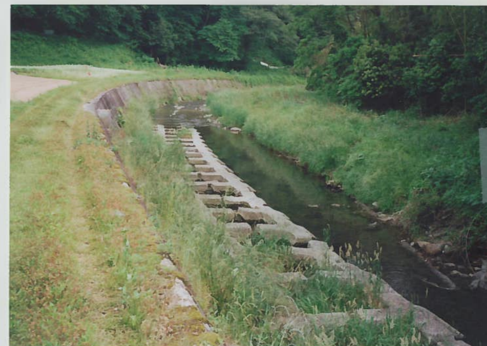
9)関川 2 洗掘防止工として 十字ブロックを敷設 している。
