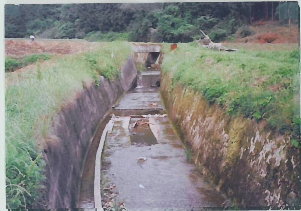
10)初摩谷川 19 三面張工+段差工で 魚の移動は難しい。
