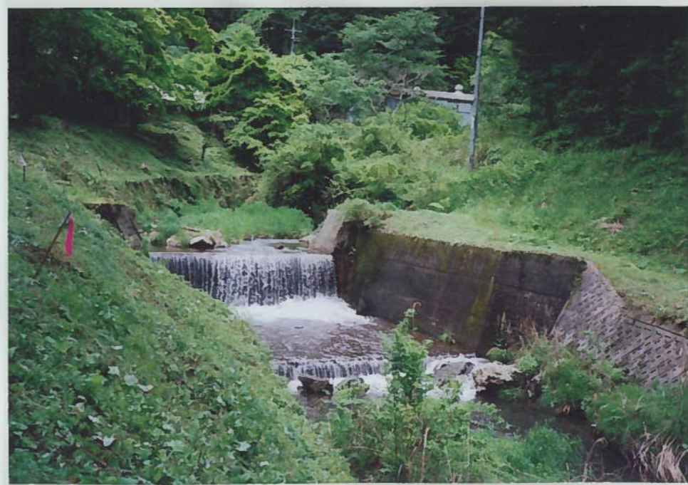
5)西河内川 9 h=2m 魚の遡上は難しい。
