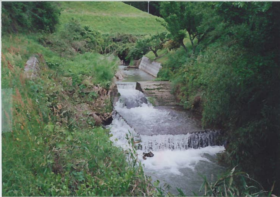
5)西河内川 5 h=1.5m 床固めコンクリートが 広い。
