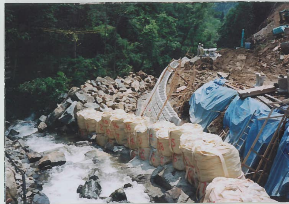
4) 弥谷川 31 道路工事中 ブロック積み擁壁として いるが自然石も多量 にある。
