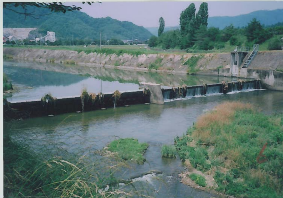
2)備中川 9 h=2m 可動式取水工
