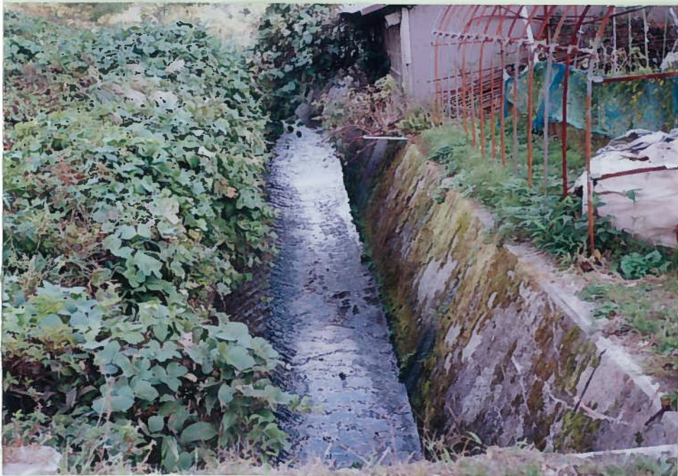
52)戸谷川 29. 三面張工 牛舎・放牧地あり、 降雨時には糞尿が流 れ込むことあり。
