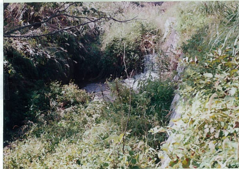
52)宮城川 34. 護岸工+床止工 h = 1 m ヨシが茂るが魚はいない。
