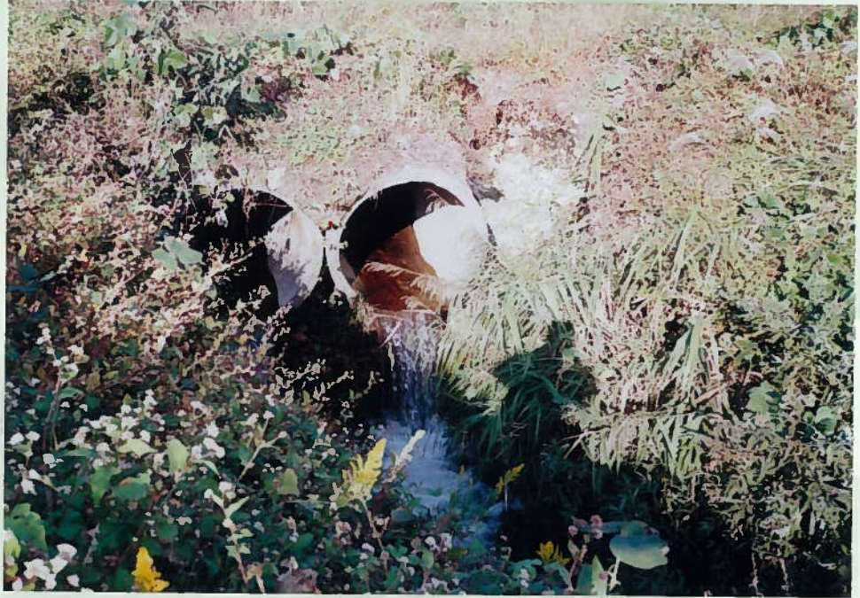
52)高松川 25. 道はパイプを布設し ている。 魚の遡上は不可能で ある。
